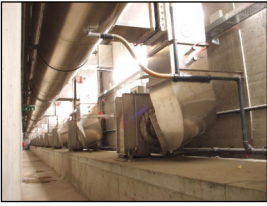
Ventilatoren für Tunnelzuluft
