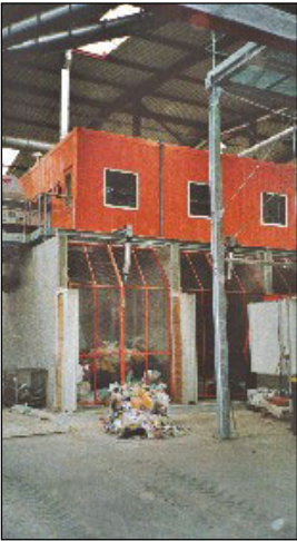
Sortierkabine mit Abwurfschacht
