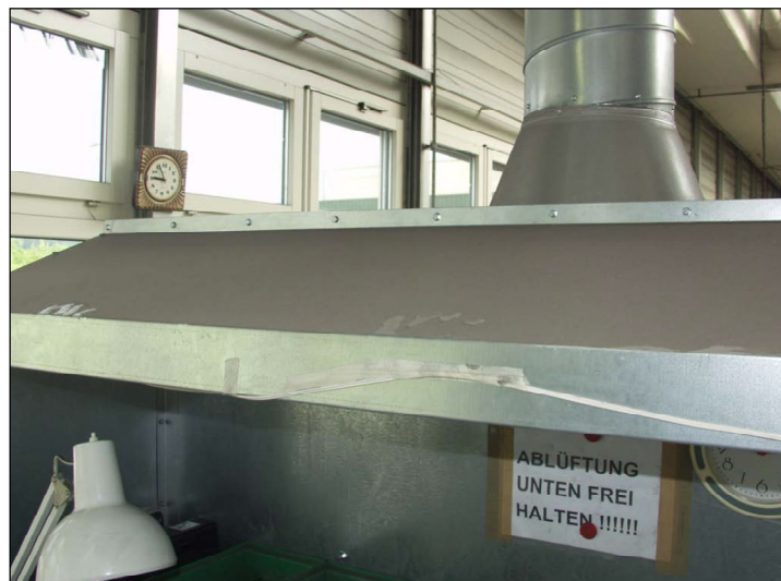
Abbildung 14: Arbeitsplatzabsaugung am Demontagearbeitsplatz (Quelle: EMPA, 2011).
