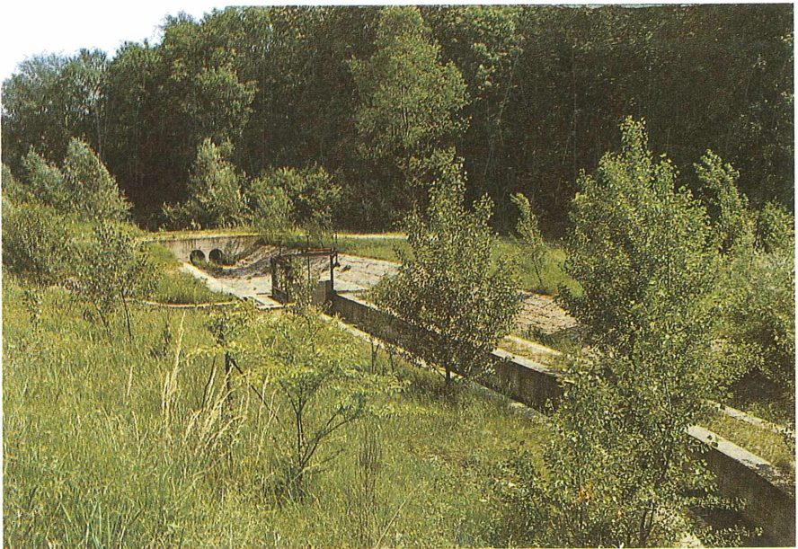
Ein Verteilerbauwerk im Stauraum Wallsee-Mitterkirchen leitet das Wasser aus dem Dotationsbauwerk in die Auwälder
