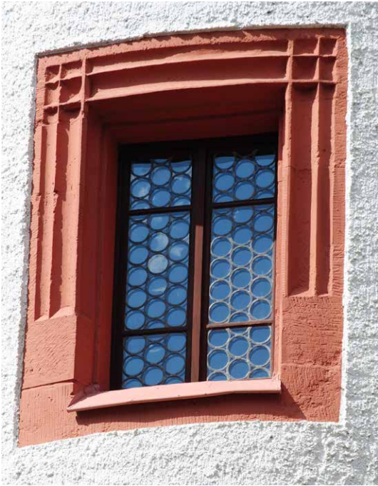
Abb. 7 Renaissance-Fenster am Schloss Schlettau mit originalen Gewändeteilen aus Zeisigwald-Tuff, bei der Restaurierung farbig überfasst.
