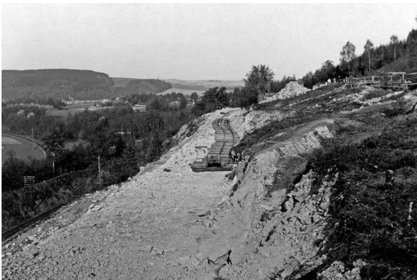
Abb. 20 | Schienenverlegung auf einer Abbaustrosse für die Abtragungsarbeiten. Foto A. Köhler, Freiberg, vermutlich 1931 (Archiv LfULG).
