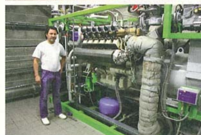
Oben: Die Gülle wird in die Vorgrube gebracht. Unten: Der Maschinenraum
