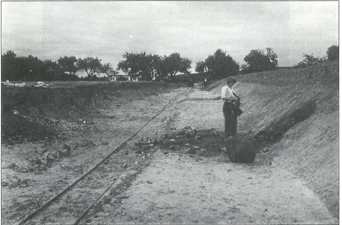
Abb. 2: Bahnbau in Pinkafeld, Herbst 1924, rechts in der Böschung die Fundstelle der Bronzelampe
