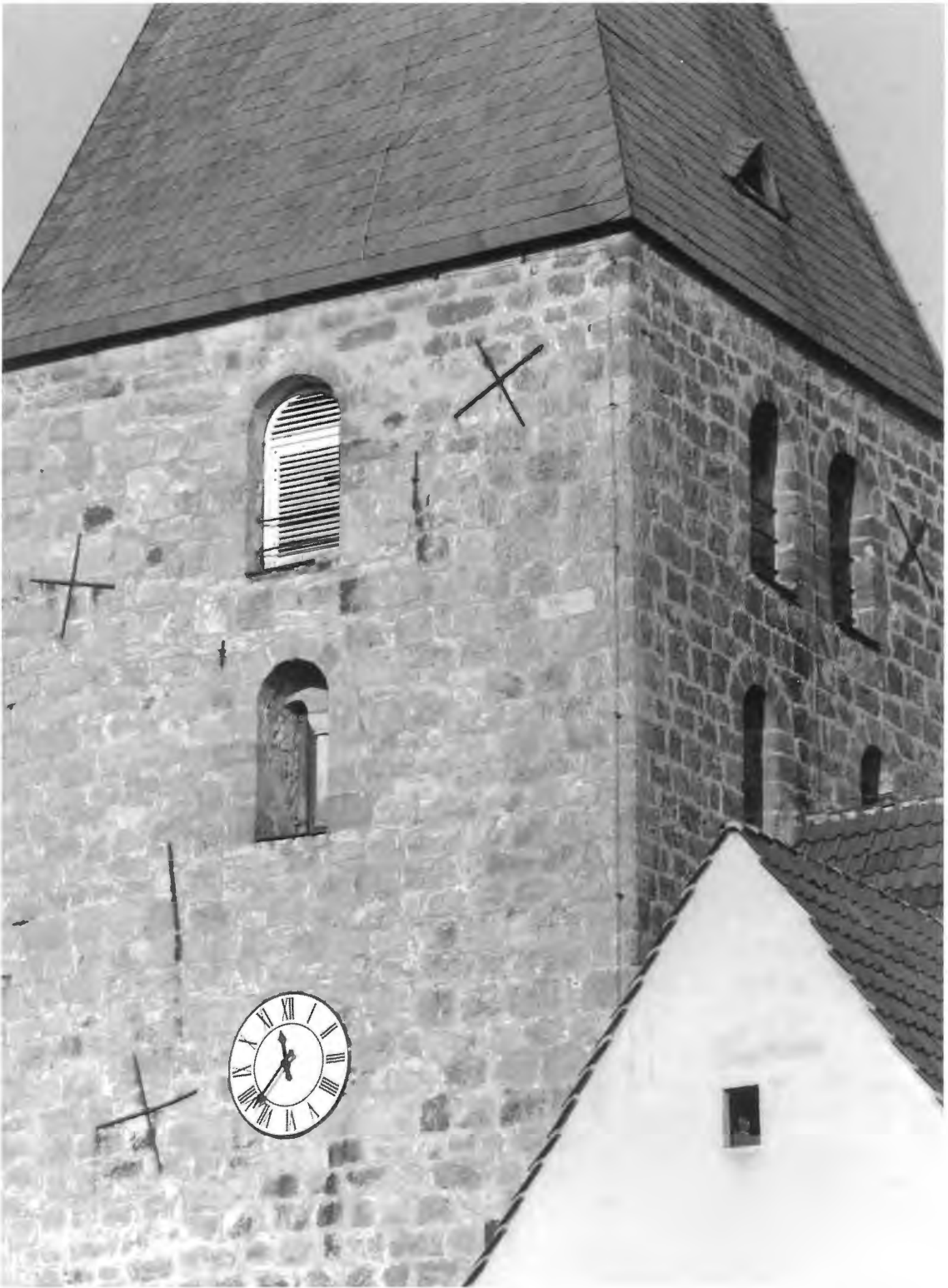
Abb. 3 Der aus der 1. Hälfte des 13. Jahrhunderts stammende Turm der Kirche in Detmold-Heiligenkirchen. Er wurde nach schweren Schäden durch das Erdbeben vom 19. Januar 1767 auf allen vier Seiten mittels eiserner Klammern und Stabilisierungskreuze instandgesetzt. Foto F. Devermann, Lipp. Landesmuseum Detmold.
