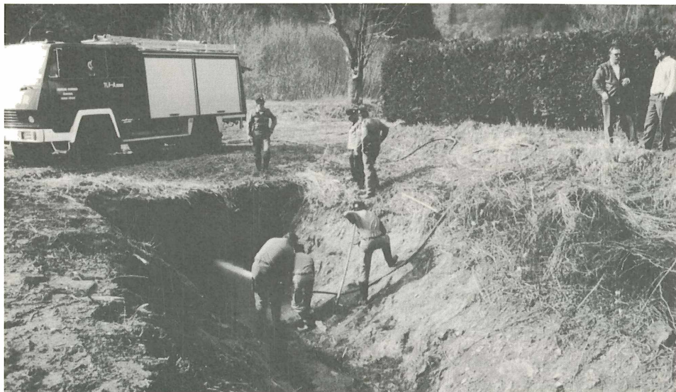
Die Feuerwehr Glanegg/Maria Feicht half mit, die verlegten Zuleitungsrohre zu reinigen, um die Wasserversorgung der alten Glan sicherzustellen.
