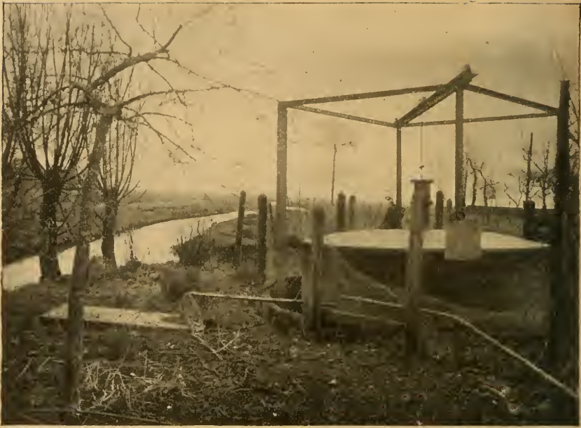
Verdeckter Gasbrunnen und Hauptgasometer einer Sumpfgasanlage in Strückhausen.
