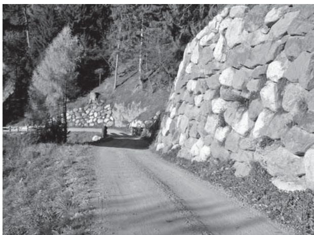
Der Hoferschließungsweg zu den Muthöfen wurde im Auftrag der Landesregierung vom Forstinspektorat Meran in Regie durchgeführt.
