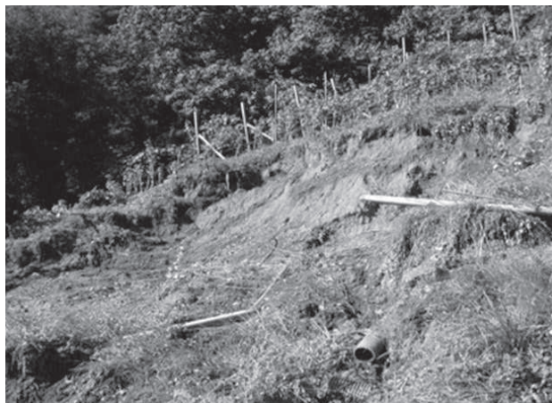
Murabbruch in einem Weinberg
