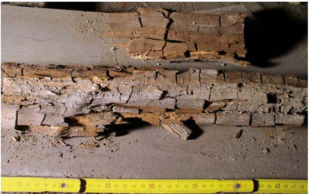
Abbildung 4. Braunfäule (Würfelfbruch) des Holzes nach Befall durch Serpula lacrymans . – Foto: MÄTES II, Wikipedia.
