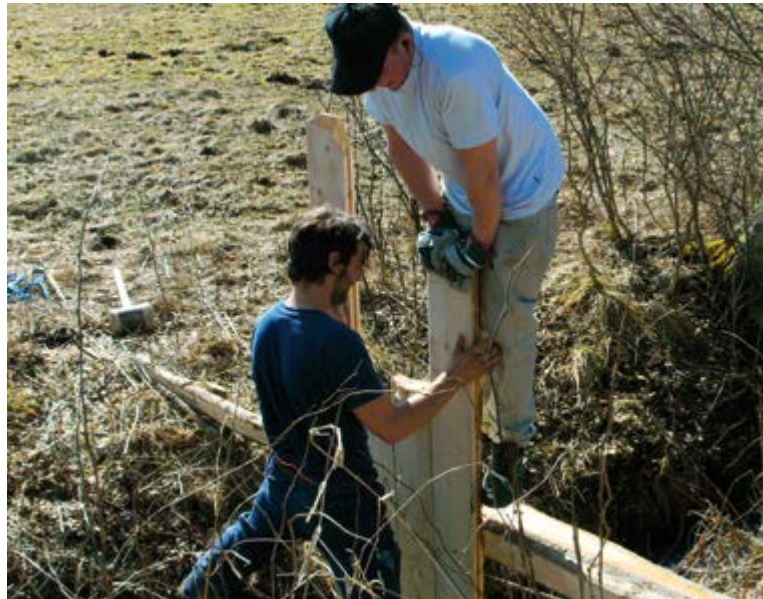
Abb. 2: Arbeiten für die Gesellschaft: Teilnehmer von „Tagwerk“ errichten einen Damm in den Loisach-Kochelsee-Mooren und leisten damit einen Beitrag zum Klimaschutz (Foto: Oliver I. Hoffmann).
