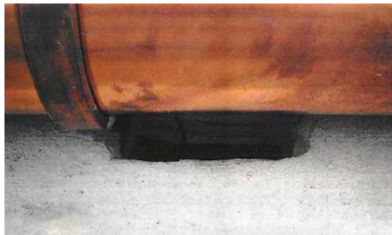
Abb. 4: Die Mauersegler-Einflugöffnung wurde im Zuge der Sanierung auf das für Mauersegler nötige Maß verkleinert.
