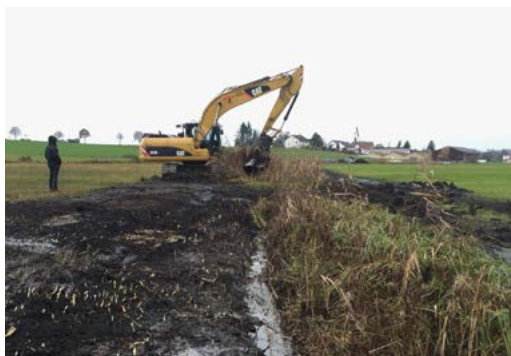
Abbildung 15 Vorsichtige Uferabflachung ohne Eingriff in die Sohle. Die Grabensohle wurde während der Ufergestaltung nicht beeinträchtigt (Foto: Martin Königsdorfer).
