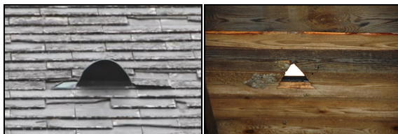
Lüfter: links außen, rechts innen. Kirche Lackenbach
