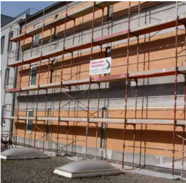
Abb. 90: Auf der Rückseite wurden aus klimatechnischen Gründen alle Fenster entfernt, abgemauert und die Fassade ebenfalls gedämmt (2007).
