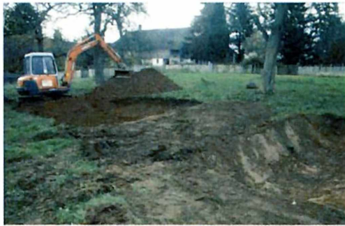
Abb. 5 Die „Situation Drautal“ wurde im Gehege zwar mit verringerter „Straßenbreite“, aber mit identischer Böschungsneigung und identischem Grabensystem simuliert.
