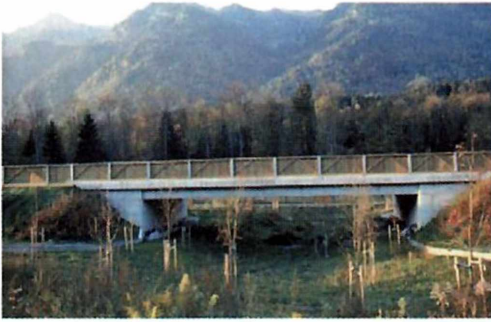
Abb. 15a Ansicht einer der für die neu errichtete Bundesstraße B100 „Drautalstraße“ entwickelten Querungshilfen für Wildtiere in Form einer Unterführung
