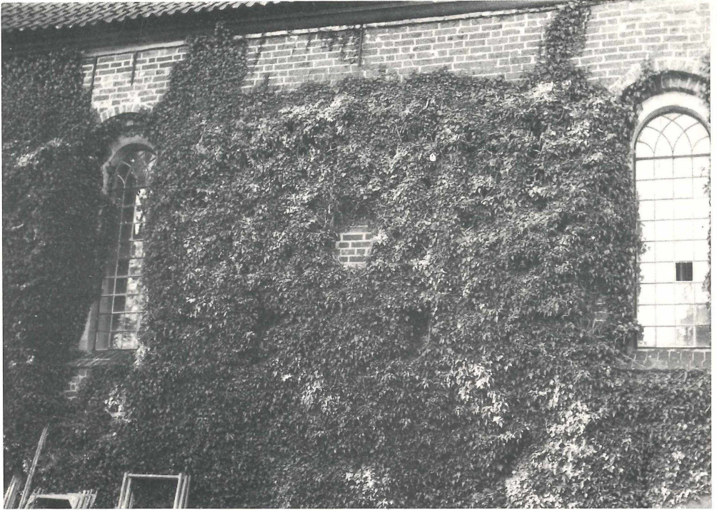
Abb. 1: Efeubewachsene Südwand der Kirche Fedderwarden, Wilhelmshaven (Photo: Verf.)
