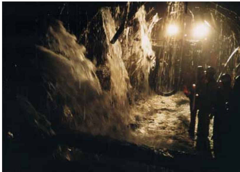
Abbildung 3: Massive Bergwasserzutritte beim Tunnelbau
