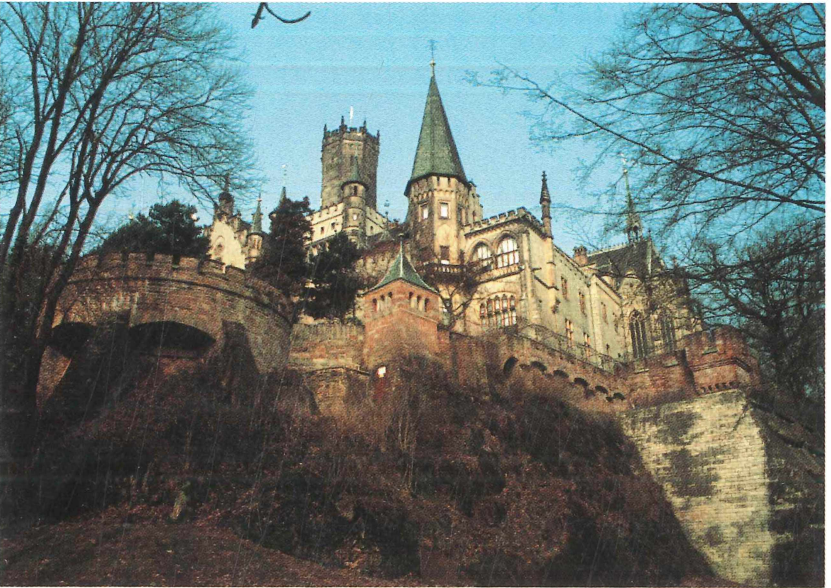
Abb. 5: Schloß Marienburg, Ansicht von Südosten mit Außenmauer aus Buntsandstein-Quadern und Bossen-Verblender aus Thüster Kalkstein vor der Felsverankerung.
