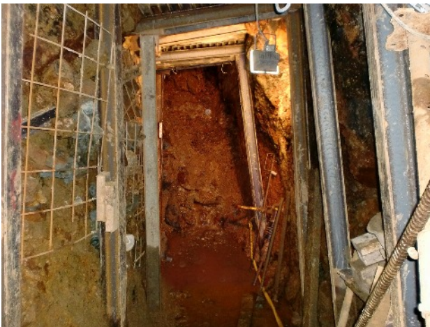
Abb. 7 Ortsbrüst der 1. Sohle ca. 20 m nordwestlich des 3. Gesenks. Das Foto markiert das Ende der Sanierungsarbeit von 2012. Hinter den Verbruchmassen verläuft die 1. Sohle wahrscheinlich noch 75 m bis 79 m weiter nach NW bis zur ursprünglichen Ortsbrüst von 1669/70. Foto Th. Giesler, März 2012.
