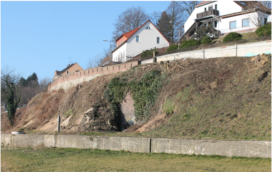
Abb. 2: Ursprünglicher baufälliger Zustand der Stützmauer im Februar 2015.
