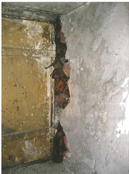
Abb. 6: Blick in die Mauernische am Dachboden die zum Kamin führt. An manchen Tagen hingen einige Tiere am Ausgang des Spalts. 17.12.2004.
