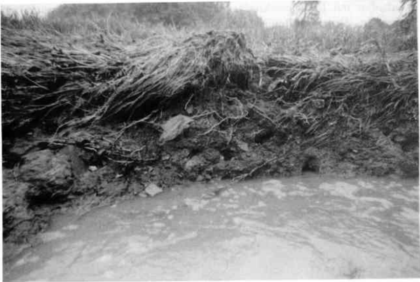
Abb. 12: Uferschaden nach einem starken Gewitterregen im Bereich des Standort Nr. 13
