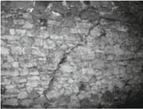
Abb. 6: Setzungsrisse in den unterirdischen Gängen in Nähe des Windmühlenrondells. Aufnahme 19.09.2011.
