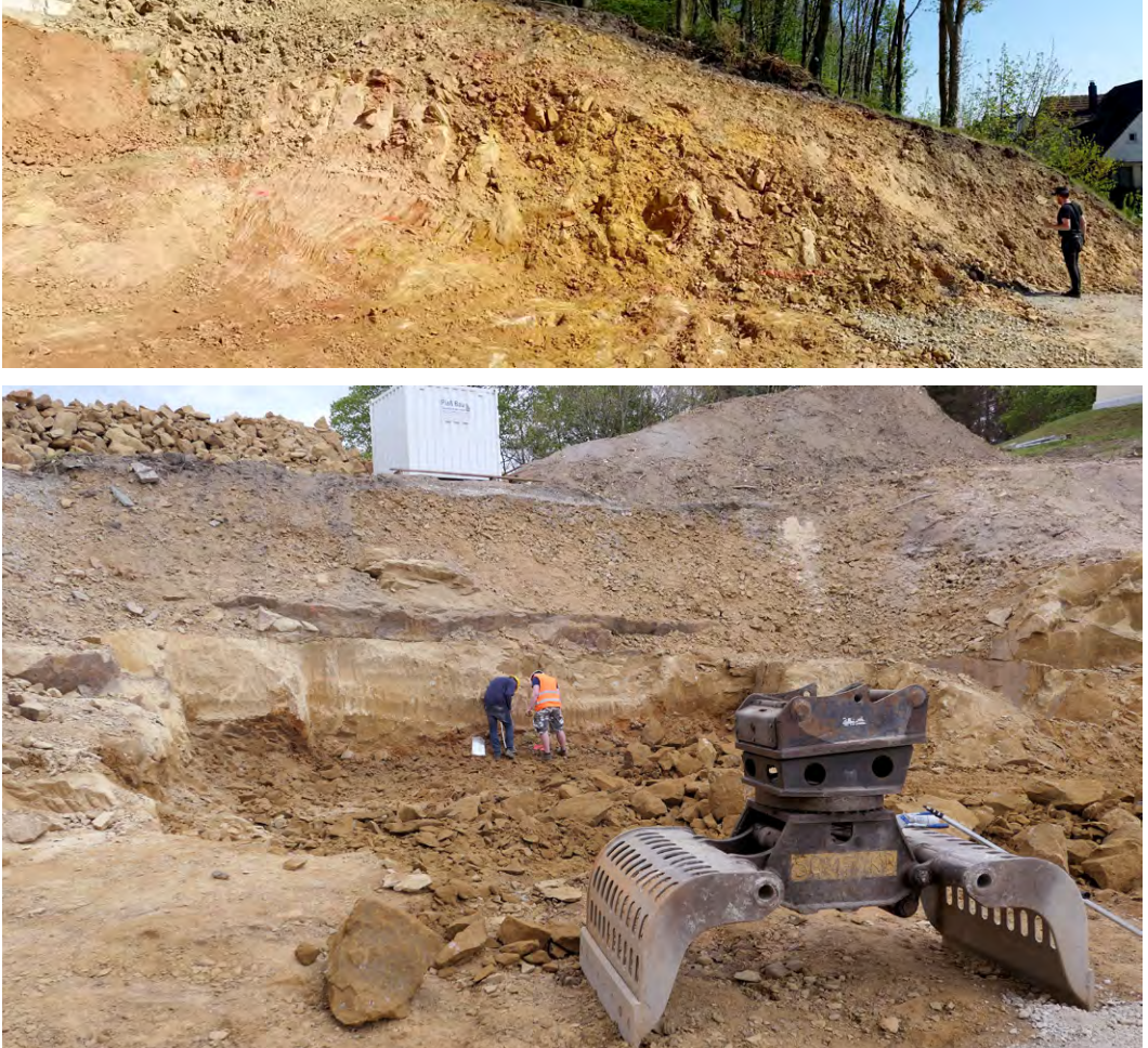
Abb. 6: Die Bauarbeiten am Tönsberg in Oerlinghausen schufen hervorragende Aufschlussverhältnisse. Oben: Blick auf die SE-Wand, unten: Blick auf die N-Wand.
