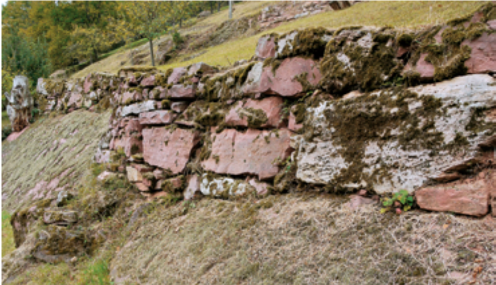
Abb. 3: Sandsteinmauer in den aufgelassenen Weinbergen westlich Aura. Auf anstehendem Sandstein an der Basis wächst großflächig das Hedwigietum albicantis , auf den Bruchsteinen der Mauer Bestände mit Grimmia pulvinata und Leucodon sciuroides .
