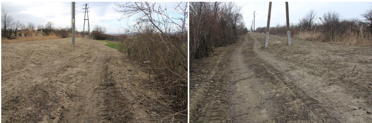
Abb. 9: Durch den Bau einer Fernwärmeleitung wurden im Herbst 2015 artenreiche Feucht- und Magerwiesen am Wiener Neustädter Kanal zerstört. / Species-rich meadows were destroyed because a district heating line was built in autumn 2015 at the Wiener Neustadt Canal. Traiskirchen, 23.2.2016, © Norbert Sauberer.
