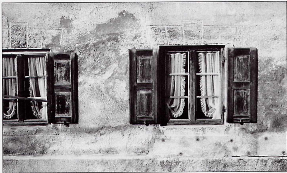
Bild 5: Teilansicht eines Bauernhauses mit Salzausblühungen und von unten her feucht aussehenden Außenwänden. Nach Messungen entspricht die Verfärbung einer erhöhten Feuchte. Nach Trocknung der Proben und Lagerung bei Außenklimaverhältnissen hat sich aber der erhöhte Feuchtegehalt wiederum eingestellt. Es handelte sich somit nicht um „aufsteigende“ sondern um „hygroskopische“ Feuchte, die aus der Luft entsprechend dem Salzgehalt aufgenommen worden ist.
