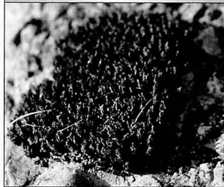
Abb.11: Moos auf Mauerwerk
