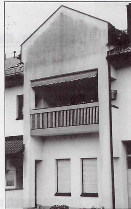
Bild 1: Unterschiedlicher Algenbewuchs an einer Westfassade: Kein oder geringer Bewuchs unter Balkon und Dachtraufe (regengeschützt) und auf Pfeiler und Tragsparren aus Beton der Gaubenkonstruktion (keine nächtliche Unterkühlung wegen großer Speichermasse). Starke Algenbildung auf der Giebelfläche der Dachgaube mit Außendämmung (Beregnung und Tauwasserbildung).
