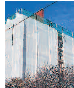
Bei der Renovierung werden leider oft auch die Zugänge zu den Bruthöhlen verschlossen.
