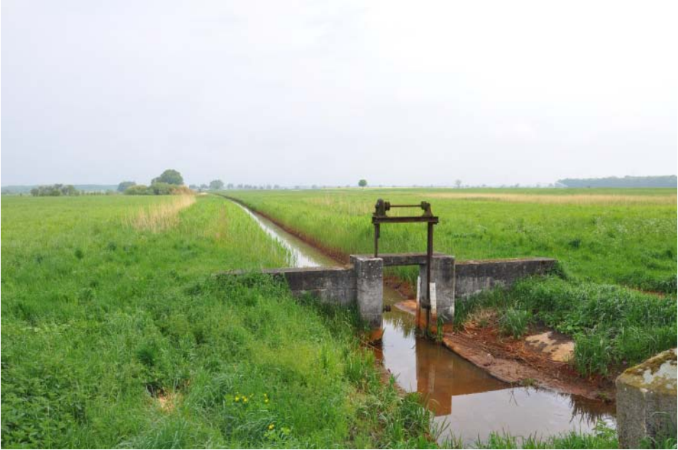
Abb. 3: Blick in einem ungeräumten Grabenabschnitt des Scheidgrabens. Zu erkennen ist die starke Verlandung des Grabens, 28. März 2011, Foto Egbert Korte – View of an uncleared ditch (Scheidgraben), showing considerable mud deposits, 28 March 2011.
