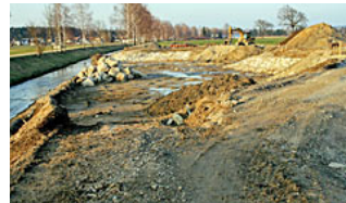
Abb. 3. Zur Aufhebung der monotonen Strömung wurden Schotterbänke und -inseln angelegt. Foto: A. Lumetzberger ©
