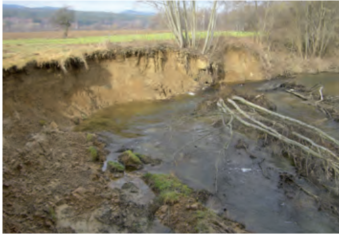
Uferanriss nach einem Hochwasser (Lafnitz).
