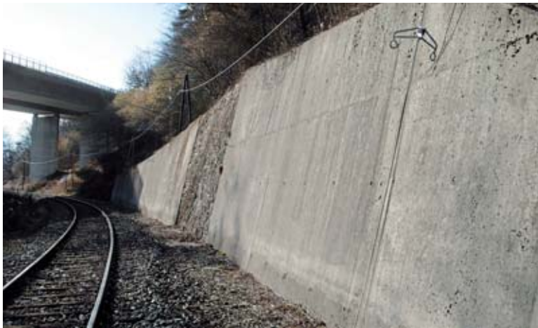
Abb. 13: Hangstützmauer Hollenburg Betonversiegelung. Mit Beton versiegelt werden die Mauern zur Todesfalle für in Spalten versteckte Tiere und nach Fertigstellung gleichen sie ökologischen Wüstenflächen. Foto: H. Happ
