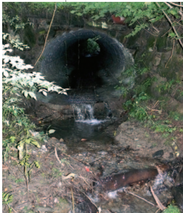
Abb. 9: Einbauten wie hier die Verrohrung bei einem Bach süd- östlich St. Martin (Gemeinde Rosegg) stellen u. a. für die Steinkrebse ein unüberwindbares Hindernis dar. Foto: eb&p Umweltbüro GmbH
