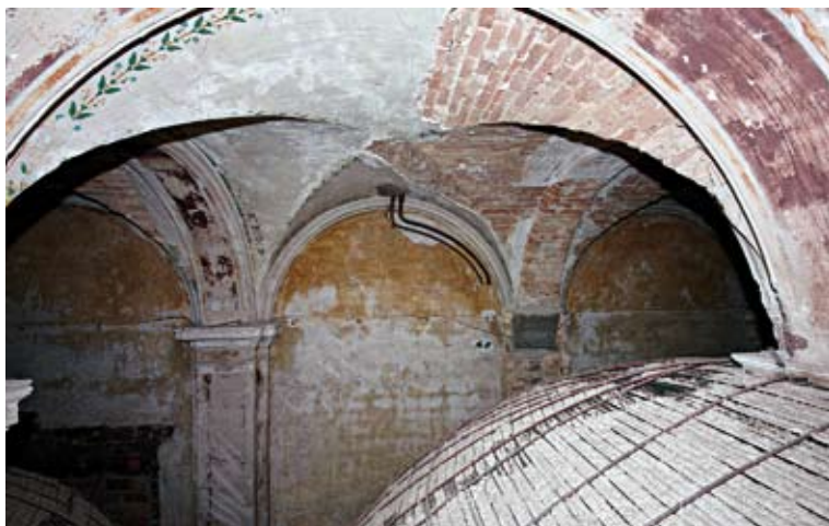
Abbildung 3. Die verschlossenen Gewölbe über den Dioramen im Parterre im Mittelteil des Hauses waren im Zuge der Brandschutzmaßnahmen erstmalig seit dem Wiederaufbau in den 1950er Jahren wieder sichtbar. Es wird diskutiert, ob man sie zugänglich für Besucherblicke machen sollte.
