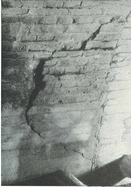
Bild 19. Beginnende Absprengung im Kalottenmauerwerk bei km 104,792.
