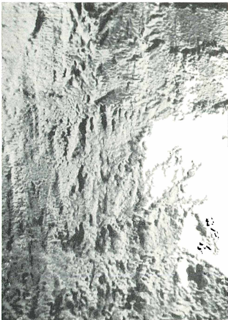
Bild 21. Frischer Kalksinter an der Innenseite des Tunnelmauerwerks bei km 104,950.
