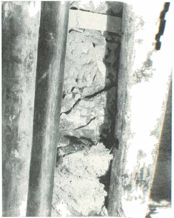
Bild 7. Abschalungen in den Schieferultramyloniten, Sohlstollen bei km 104,780.
