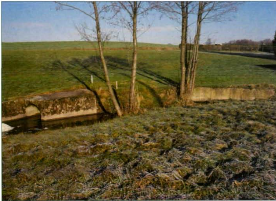
Abb. 11: Trotzdem die meisten Anwohner ihre Abwässer in die Gemeindekläranlage entsorgen, gibt es noch Anlieger, die den Überstand der Hauskläranlage in die Rotach einleiten. Da der Biber im weiteren Verlauf des Gewässers kleine Dämme anlegte, stauten sich die Abwässer zu einem übel riechenden kleinen See auf. Zur Abhilfe wurde der Anlieger genötigt in das Abwassernetz der Gemeinde zu entsorgen.
