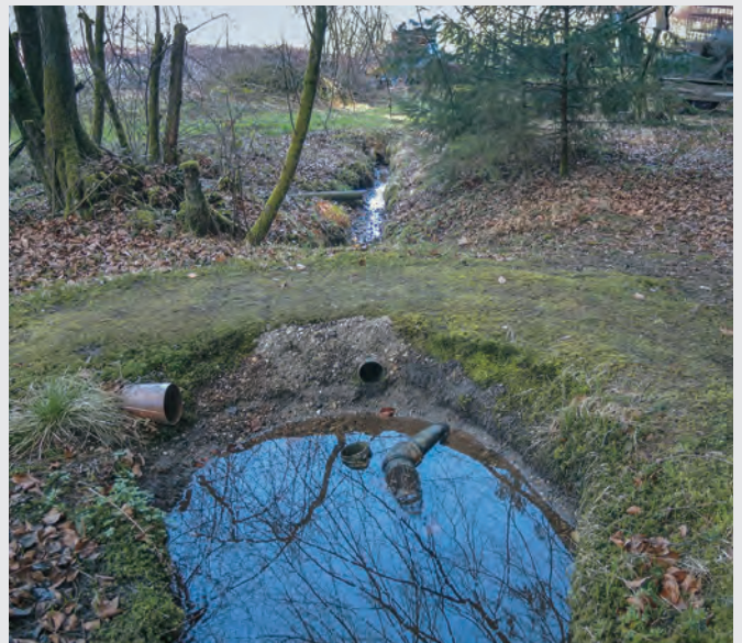
Abb. 26: Komplett-Ableitung des Lindelbauern-Bachls am Waldeck bei Punkt N 48.57485° E 013.35215°. Im Hintergrund der Graben, der die Verbindung zum Gründoblbach herstellen sollte, doch die beiden dafür gedachten Ausleitungsrohre liegen dafür viel zu hoch.
