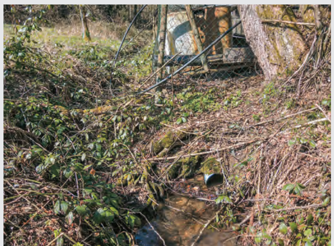
Abb. 22 : Südostecke der Teichanlage. Links der einstige Restwassertgraben, rechts davon das Rohr, durch das das gesamte Wasser aus den Teichen kommt.
