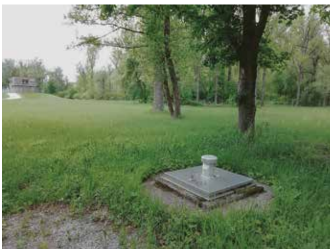
Abb. 5: Abdeckung des Schachts von Schluckbrunnen Nr. 1 (Foto: Willy Zahlheimer, 27.5.2021).
