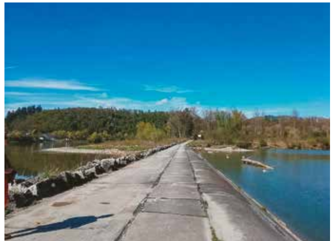
Abb. 3: Blick über den Verbindungsdamm Richtung Soldatenau. An in Beton eingebettete Wasserbausteine am Donauufer schließen sich an die Fahrbahn, einer der überdeckten Leitungskanäle und eine hydrodynamisch optimierte Böschung in den Altarm (Foto: Willy Zahlheimer, 30.4.2021).
