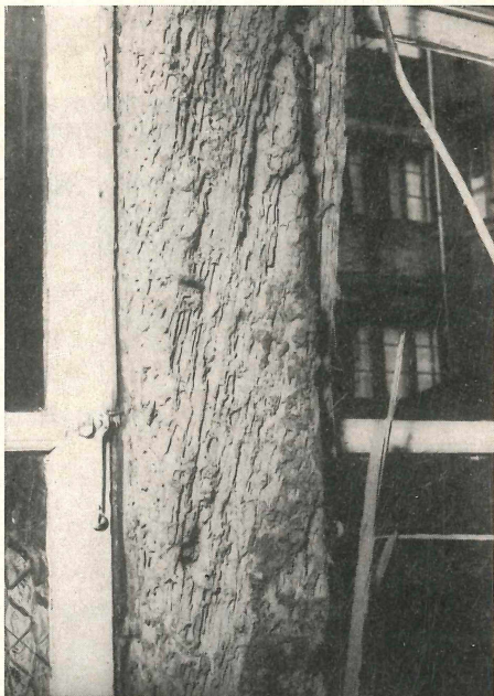
Von Termiten zerstörter Fachwerkständer.
