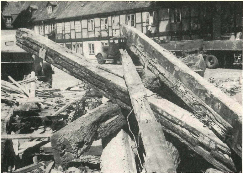
Hamburg-Innenstadt. Von Termiten zerstörte Eichenbalken.
