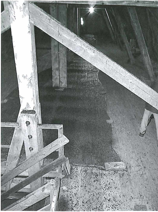
Abb. 1: Wochenstube der Mausohrfledermaus Myotis myotis im Dachstuhl einer Kirche bei Tübingen, Baden-Württemberg. Unter den ausgelegten Dachziegeln fanden sich zahlreiche überwintende Wanzen Cimex lectularius .
