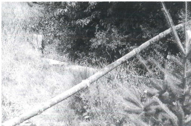
Abb. 2: Das vollständig zugeschlammte und bewachsene herkömmliche Kombinationsbauwerk aus Regenrückhaltebecken (nicht mehr erkennbar) und Holzschwellenwand. 26. Juli 1996, Foto: W. ROHE
