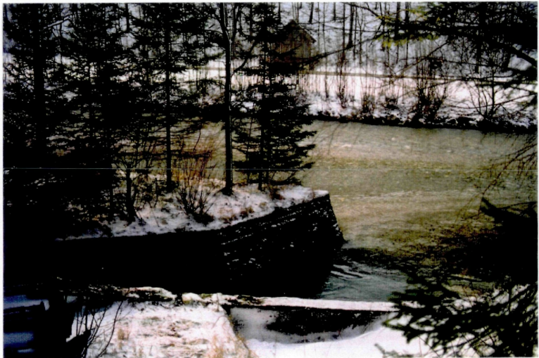
Abb. 20: Einmündung des 14 m langen Unterwasserkanales des E-Werkes in die Alm. In diesem Bereich sind die Uferböschungen beiderseits gemauert.
