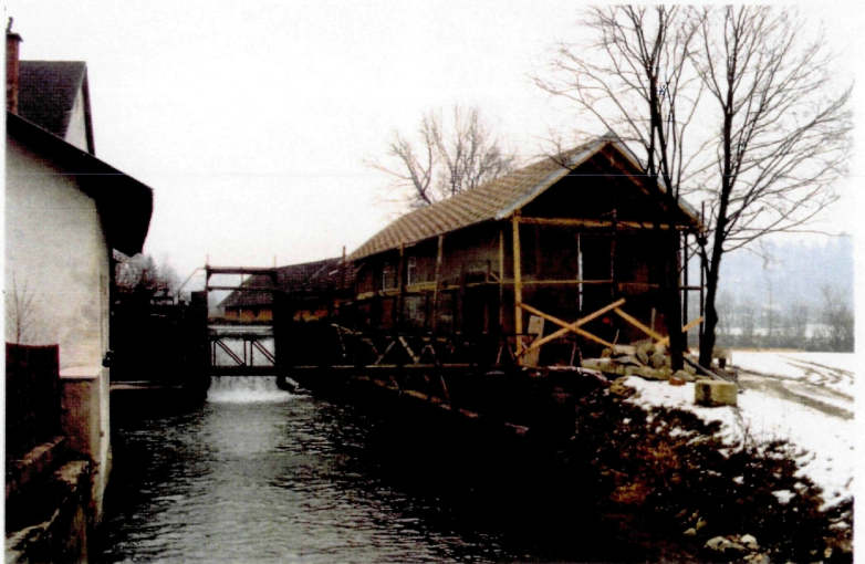
Abb. 117: Auslaufbauwerk der Reichlmühle
