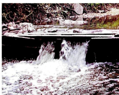
Eine Sohlstufe als Wanderhindernis.
