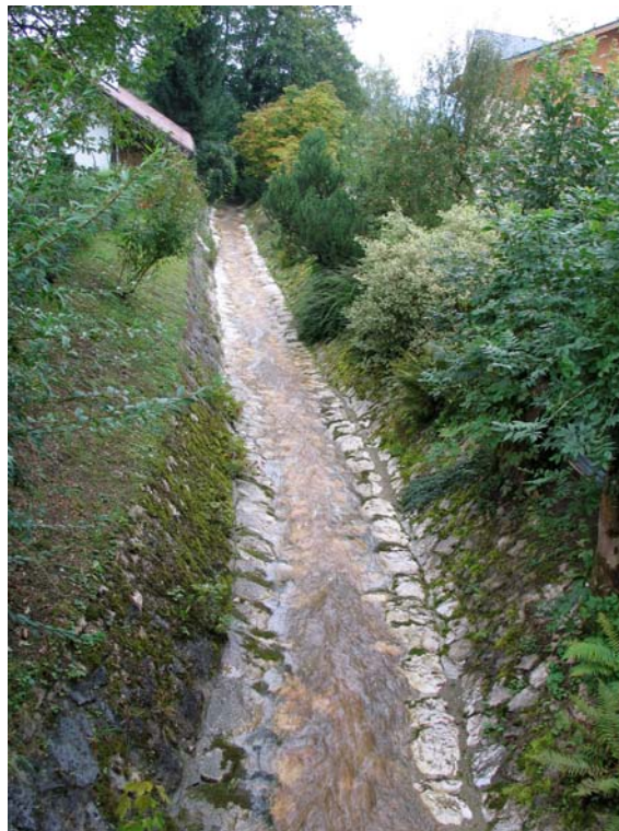
Abb. 16: Die Bäche sind im Mündungs- und Ortsbereich größtenteils hart verbaut (Ufer- und Sohlsicherungen).
