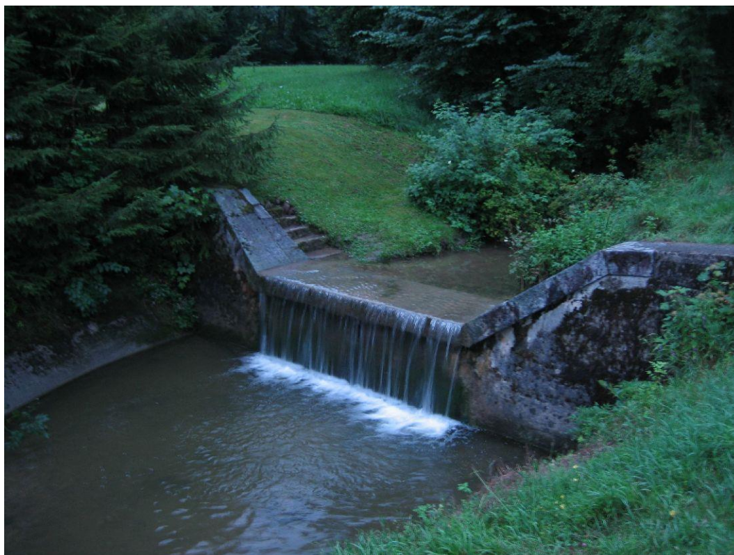
Abbildung 44: Hohe Schwelle im Bachbett eines Bachs, der vom Häfel- bzw. Gahberg kommt. (Fotonr. 200501417370131b).
