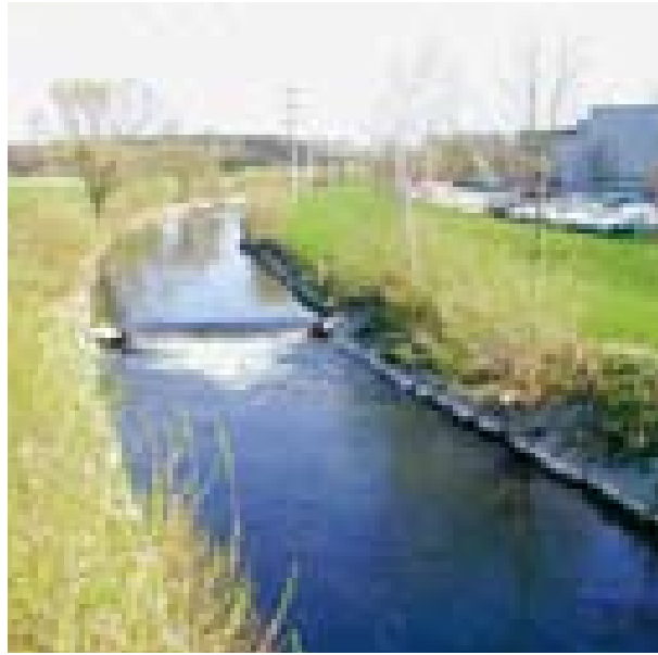
Abb. 88: Massive Ufersicherung der Antiesen entlang des Gewerbegebietes Emprechting
