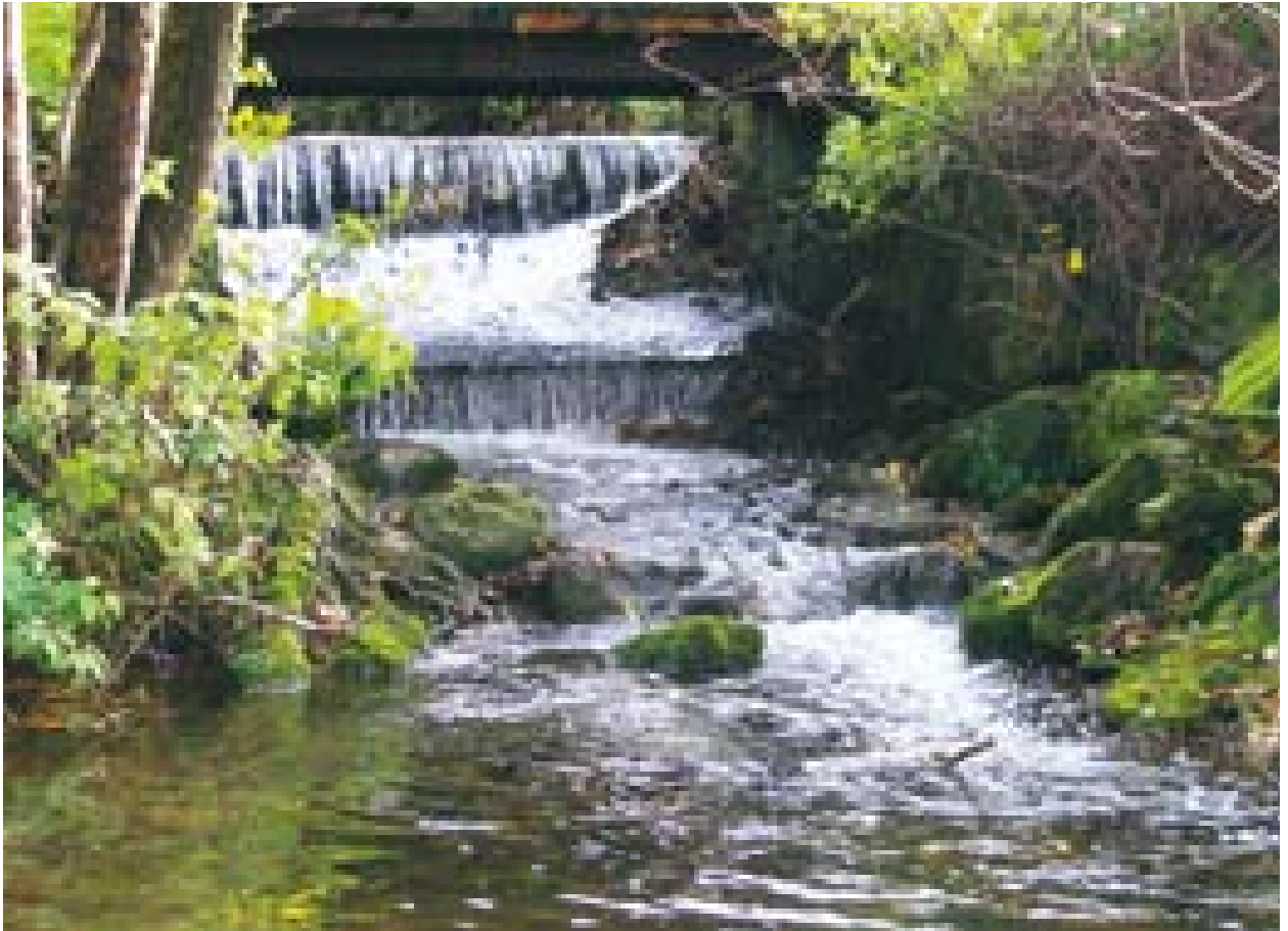
Abb. 61: Beispiel für ein unpassierbares Querbauwerk im Aubach
