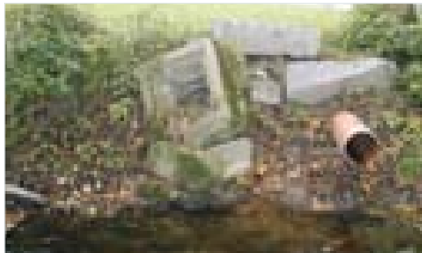
Abb. 75: Beispiel einer Bauschuttablagerung und Rohrleitung an der Breitsach
